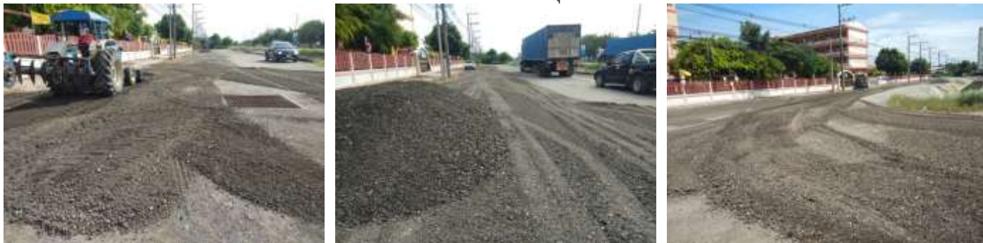
เทศบาลตำบลลาดแค ได้ดำเนินการถมหินคลุกหน้าโรงเรียนเทศบาลลาดแค
